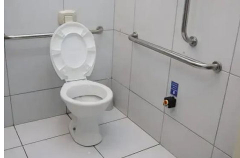
Figura 2: Sanitário acessível com dispositivo de chamada de emergência.
